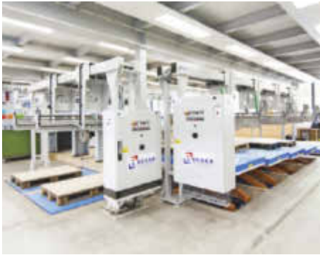
/ Die sechs Abstapelplätze von der Rückseite. In der unteren Stellung sind sie bodenbündig.
